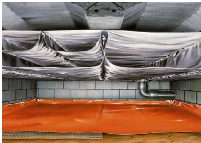
Figuur 5.1 Tonzonvloerisolatie met bodemfolie tegen vocht en radongas in de kruipruimte (bron: Tonzon)
